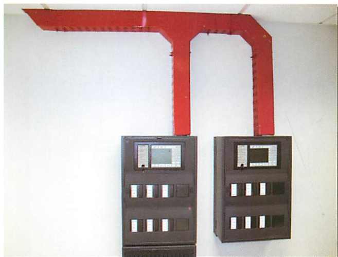
Foto 93 - Central de Incêndio do MPSE
