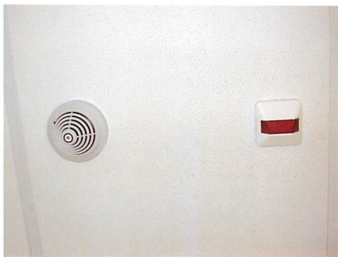
Foto 94 - Equipamentos de Detecção Preventiva de Incêndio
