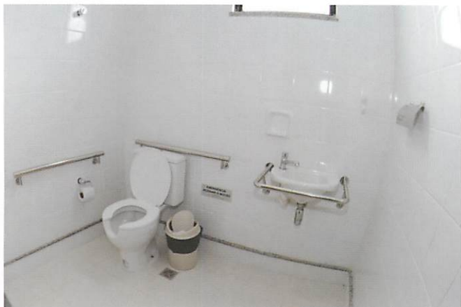
Foto 11 - Sanitário Adaptado na Subsele de Estância
